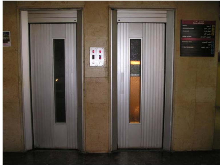
صعوبة استعمال المصعد الكهربائي في بلدية نابلس.
